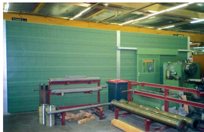
Lärmschutztrennwand in Fertigungsbetrieb
