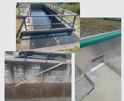
Ausstiegshilfen an Regenrückhaltebecken Climbing aid at rainwater retention basins
