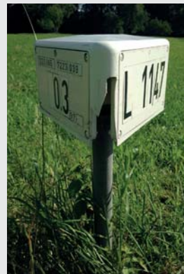
Schäden durch Mäharbeiten damages through mowing
