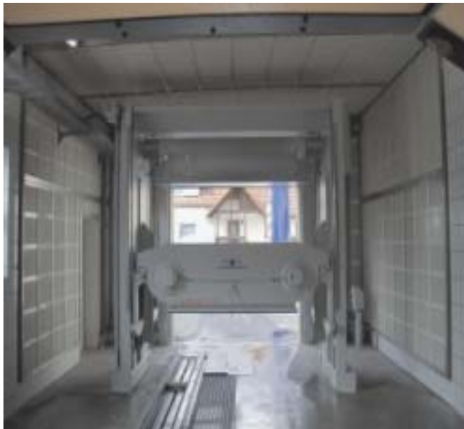
Lärmschutzverkleidung in Waschhalle
